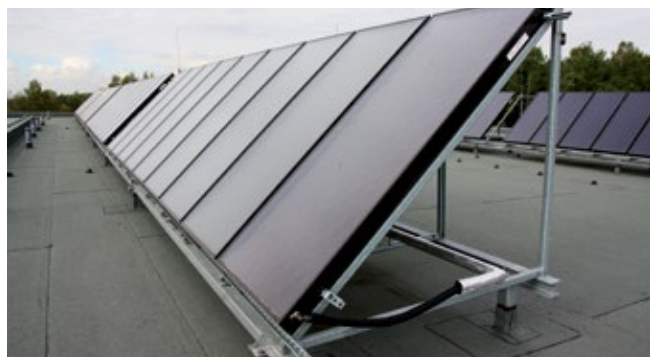
Zdjęcie 41. Kolektory słoneczne
