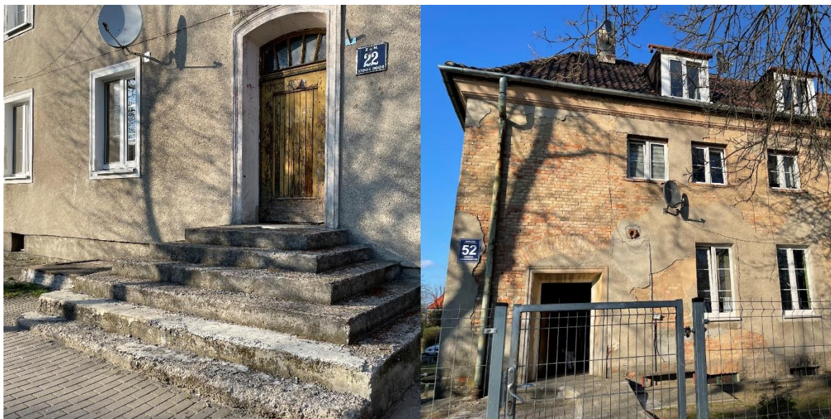
Zdjęcia 1 Stan budynków na osiedlu Bloki
